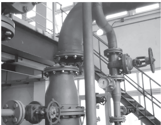
图1 发生爆炸事故的压力管道连接处
